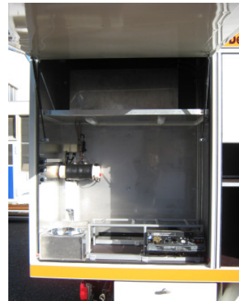
Hinter der Klappe befinden sich zwei Gaskocher, das Wasch- becken und der Warmwasserboiler. Oben wurde ein Edelstahl-Frisch- wassertank installiert. Unter dem Fahrgestell befindet sich der Ab- wassertank ebenfalls aus V2A.
